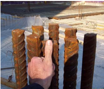
Die Anschlusspunkte für die Stützen im Bereich der Aufstandsflächen zu den Wandscheiben des Kulturzentrums wurden in C50/60 mit Bewehrung \varnothing 32-50 mm ausgeführt.
