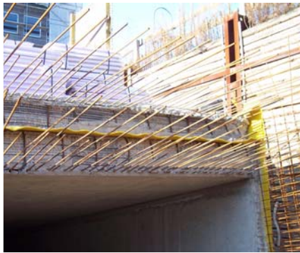
Der mit 5,50 m Erdrich belastete Tunnel der Einfahrtsrampe wurde als max. 80 cm starke Stahlbetondecke in WU-Bauweise ausgeführt.
