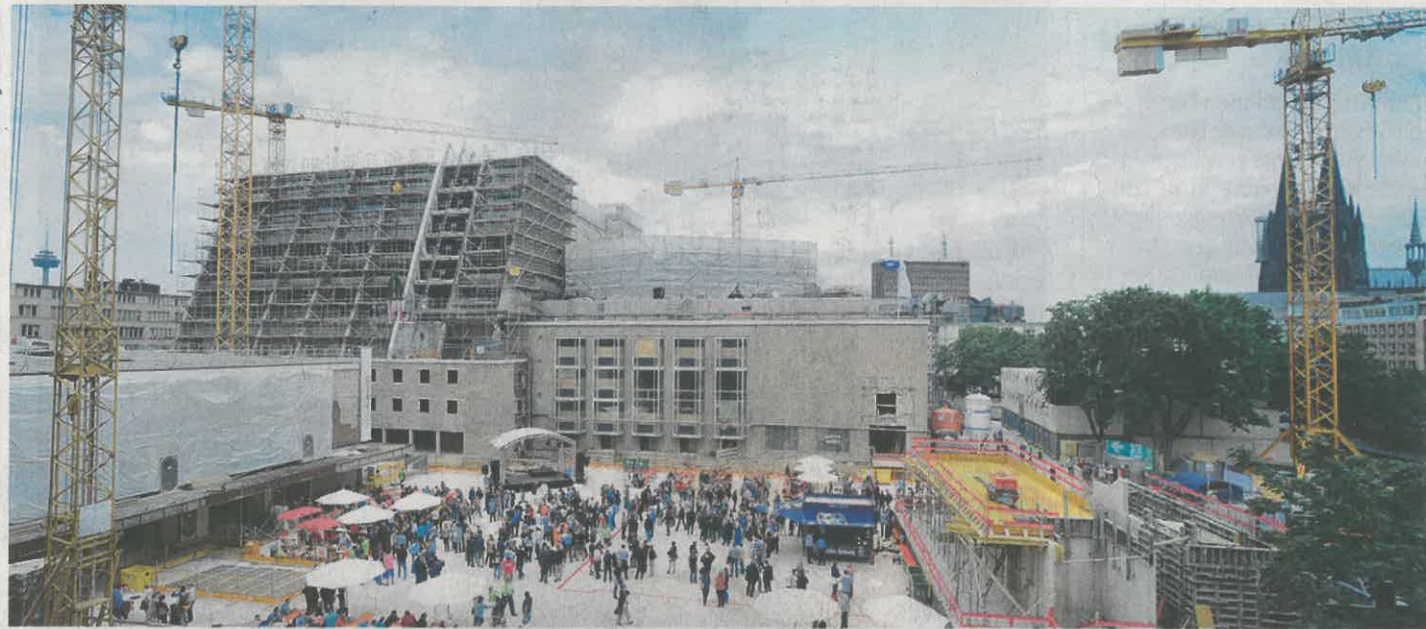
Zwei Jahre nach Beginn der Generalsanierung wurde auf der Baustelle des Opernquartiers am Offenbachplatz Richtfest gefeiert. BILDER: STEFAN WORRING
