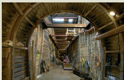
Entwässerung Industriegebiet Köln-Niehl, Kanalbau und Hochwasserpumpwerk. Tragwerksplanung. Bauherr und Foto: Stadtentwässerungsbetriebe Köln AöR.
